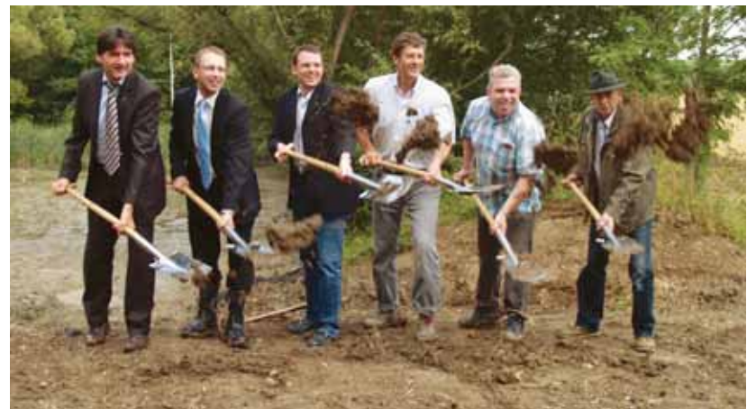
Der erste Spatenstich zur Sanierung des Rommersheimer Stauweihers, durchgeführt von Heiko Sippel, Markus Conrad, Sandor Domedian, Ralf Wester, Volker Schmand, Wolfgang Janson (v. l.).
